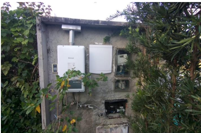
Medidores de energia
