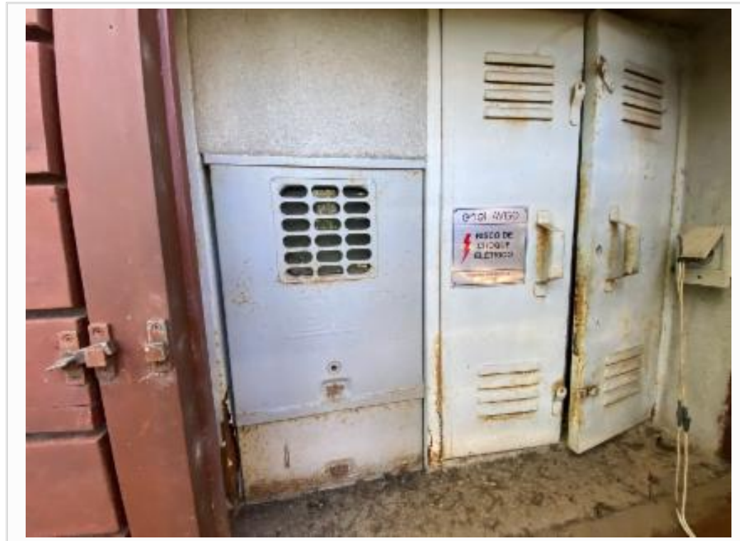
Medidor de energia
