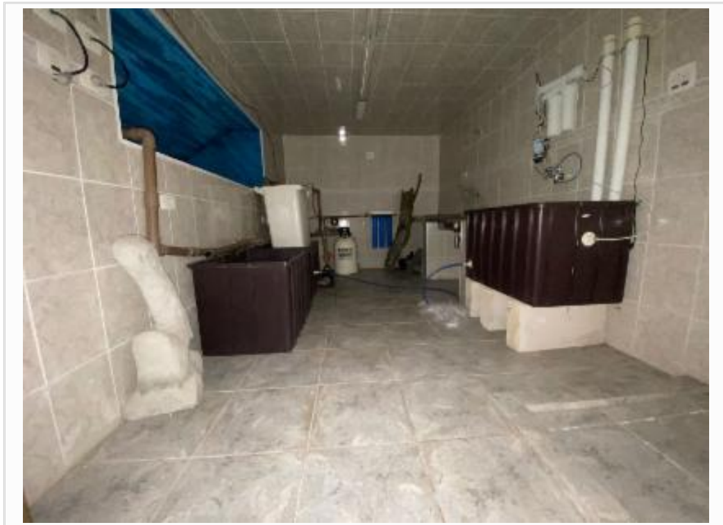
Casa de maquinas aquário - vista 1
