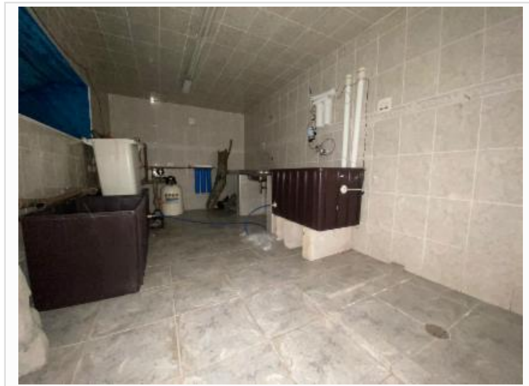
Casa de maquinas aquário - vista 2
