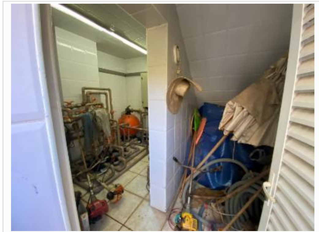
Casa de maquinas 2 - vista 1
