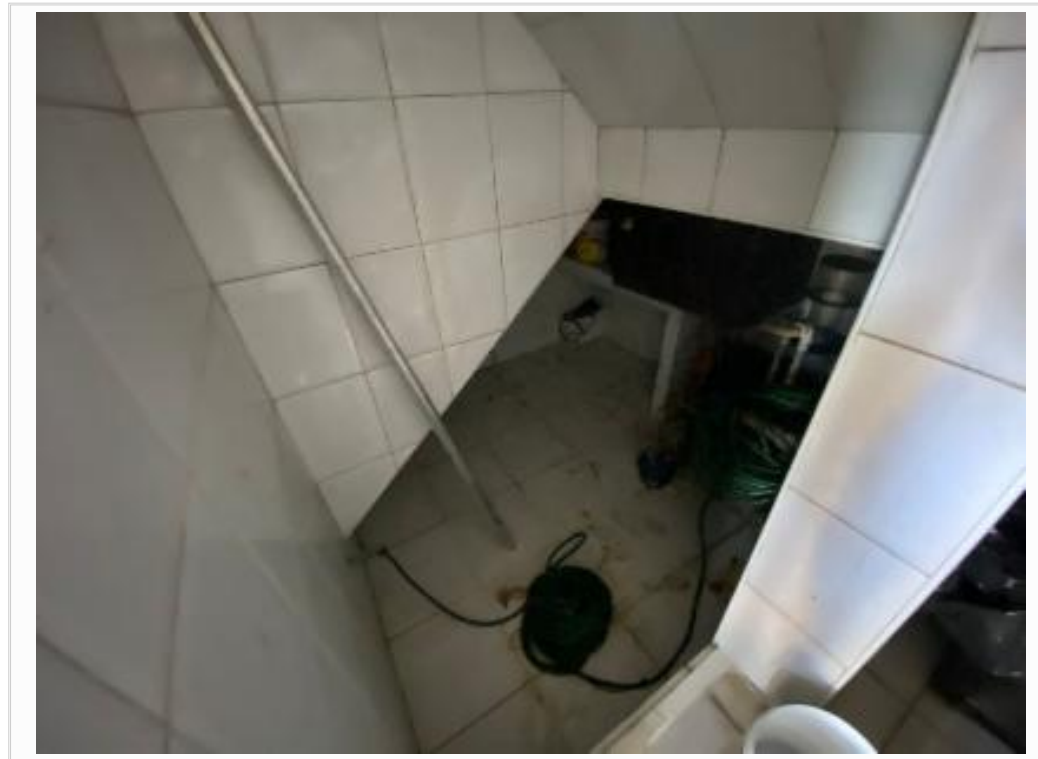
Casa de maquinas 1 - vista 2
