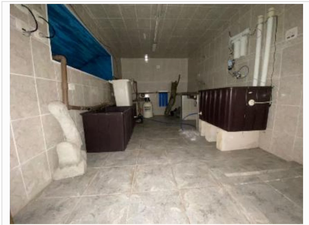
Casa de maquinas aquário - vista 1
