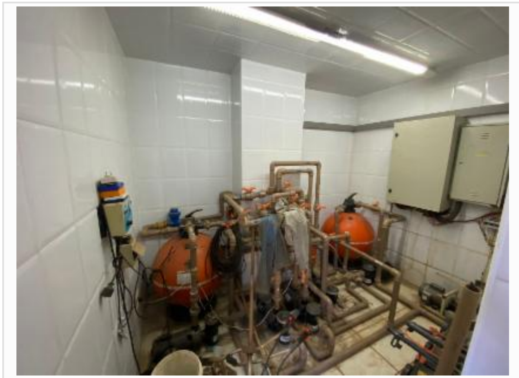
Casa de maquinas 2 - vista 2
