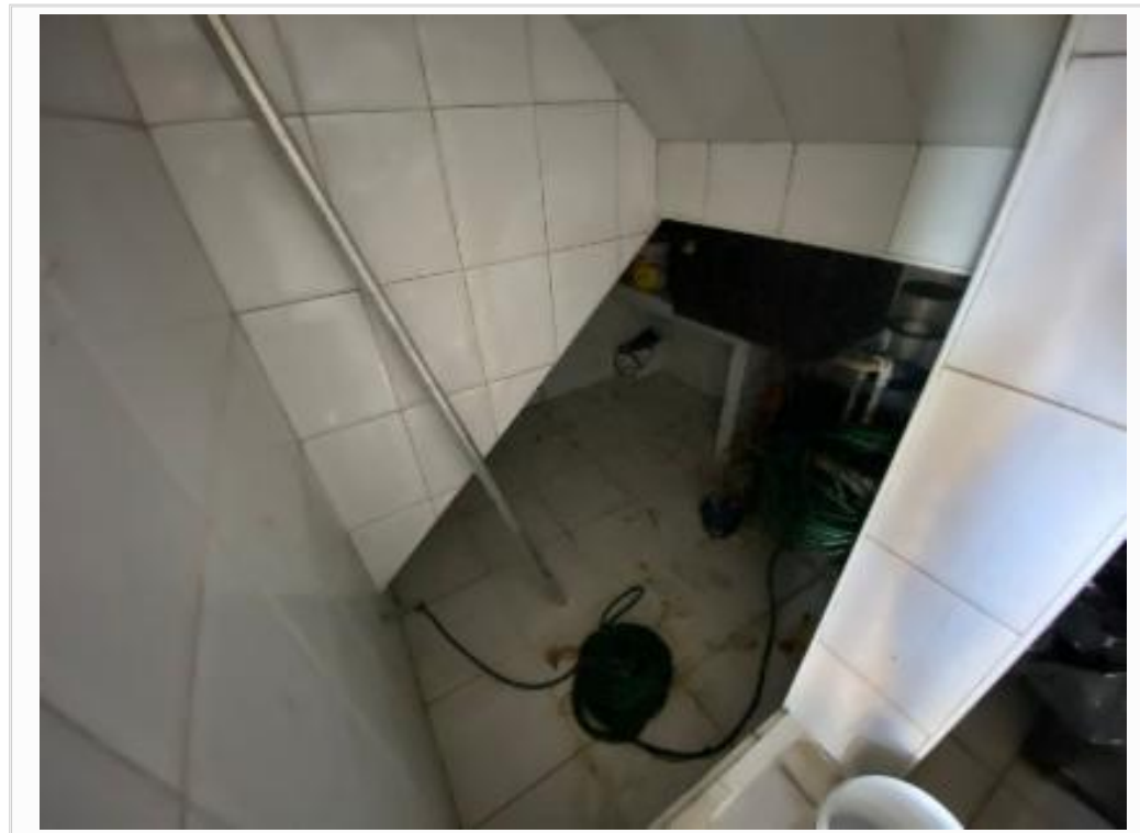
Casa de maquinas 1 - vista 2
