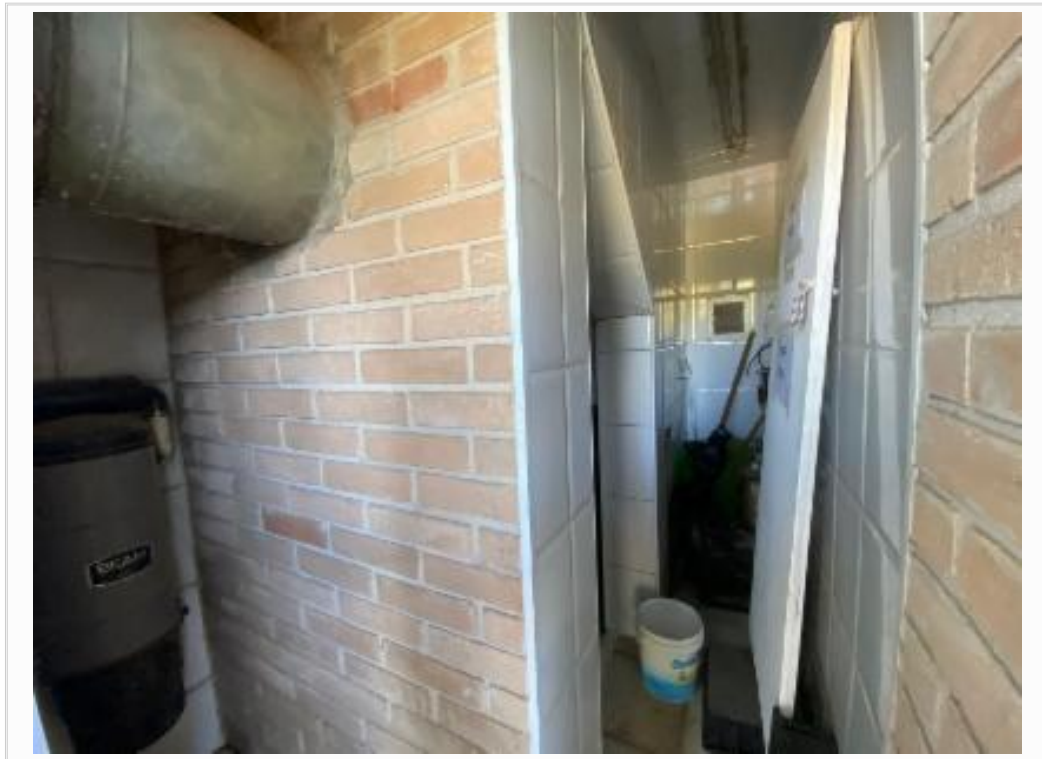
Casa de maquinas 1 - vista 1
