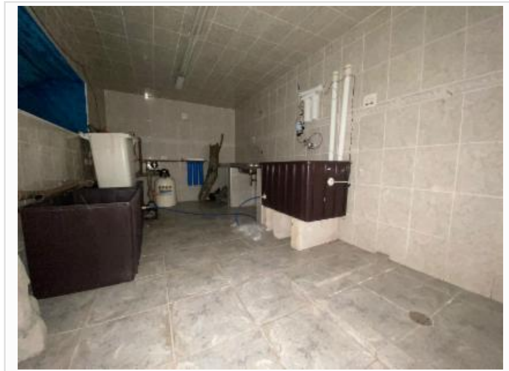
Casa de maquinas aquário - vista 2
