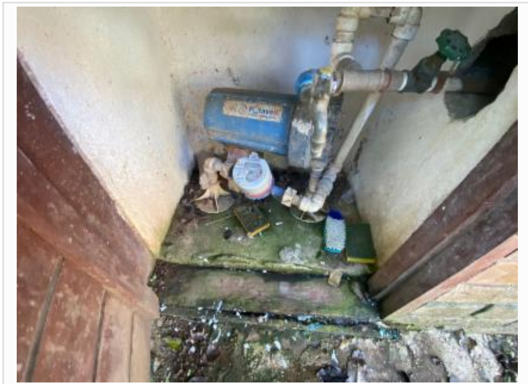
Medidor de água
