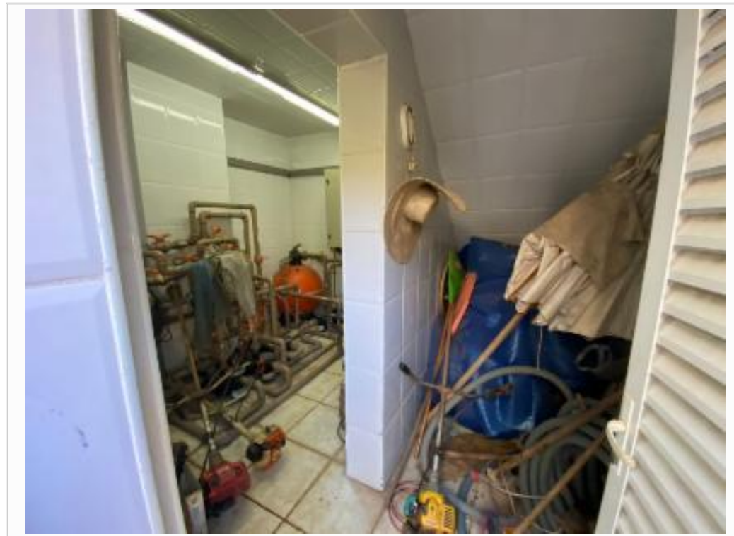
Casa de maquinas 2 - vista 1
