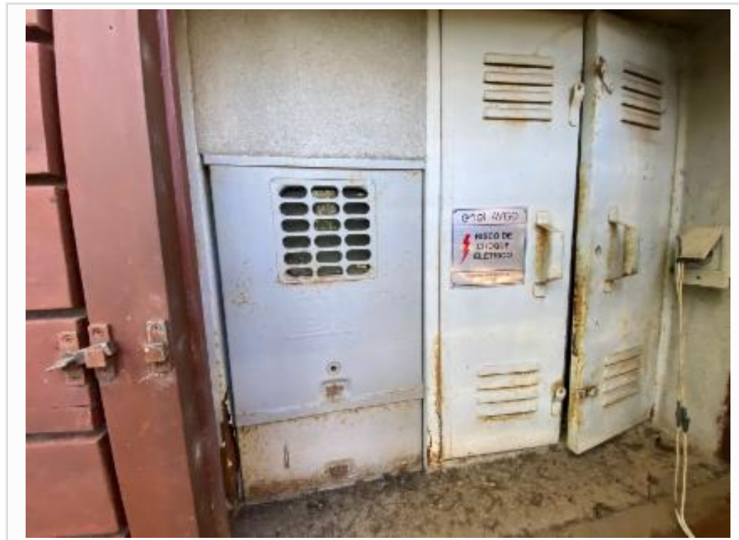
Medidor de energia
